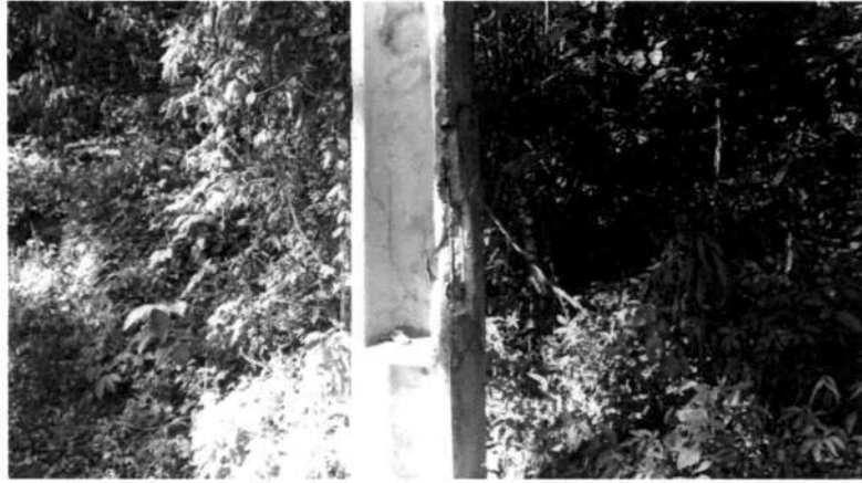
Foto 4 Poste danificado durante a manutenção da estrada
