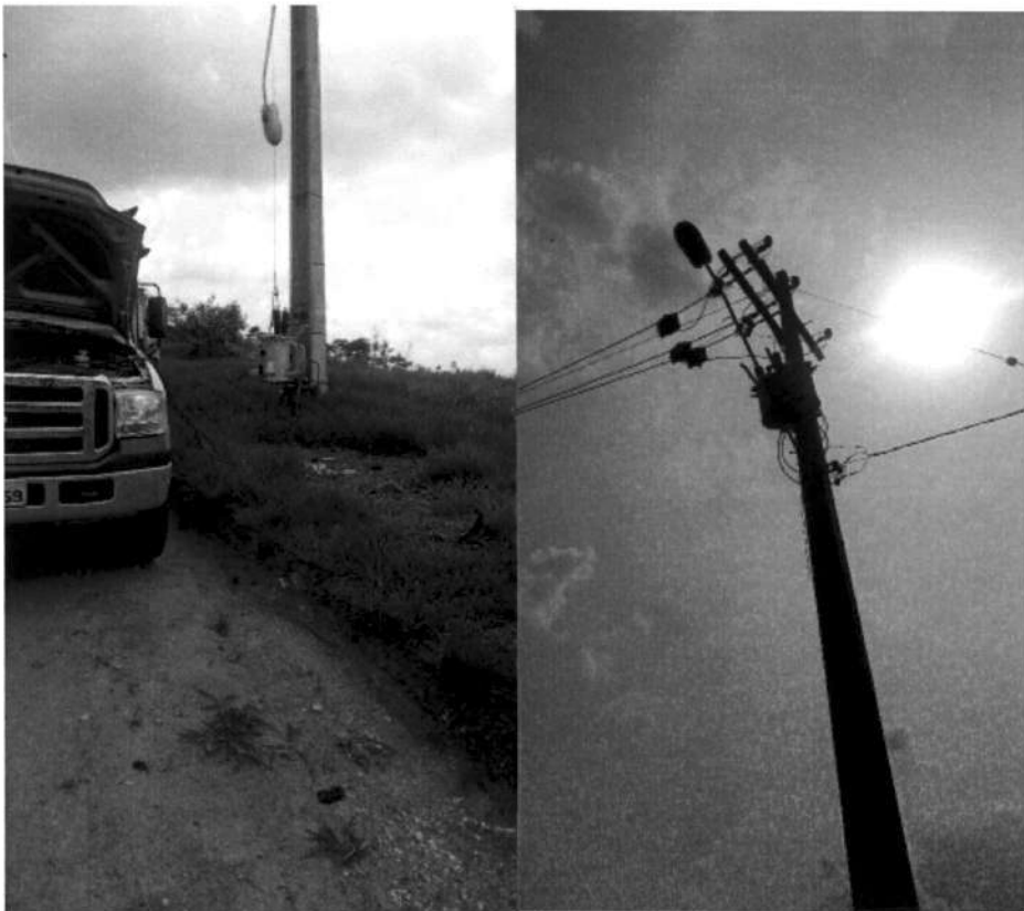
Foto 1 a 3 Instalação Transformado
