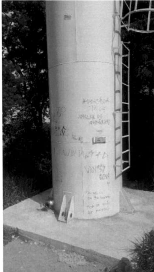
Foto 11 Caixa D'Água Vandalizada
