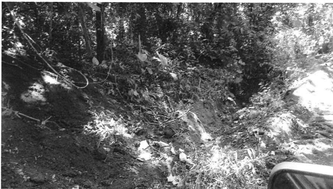
Foto 28 Saída D'Água com acúmulo de terra
