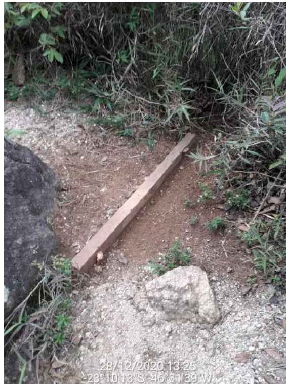
Figura 27 – Exemplo de manejo de trilha, com implantação de degrau e tratamento de drenagem.
