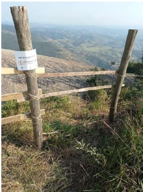
Figura 6 - Barreira localizada na laje sul mais uma vez danificada, mesmo havendo sinalização informativa.
