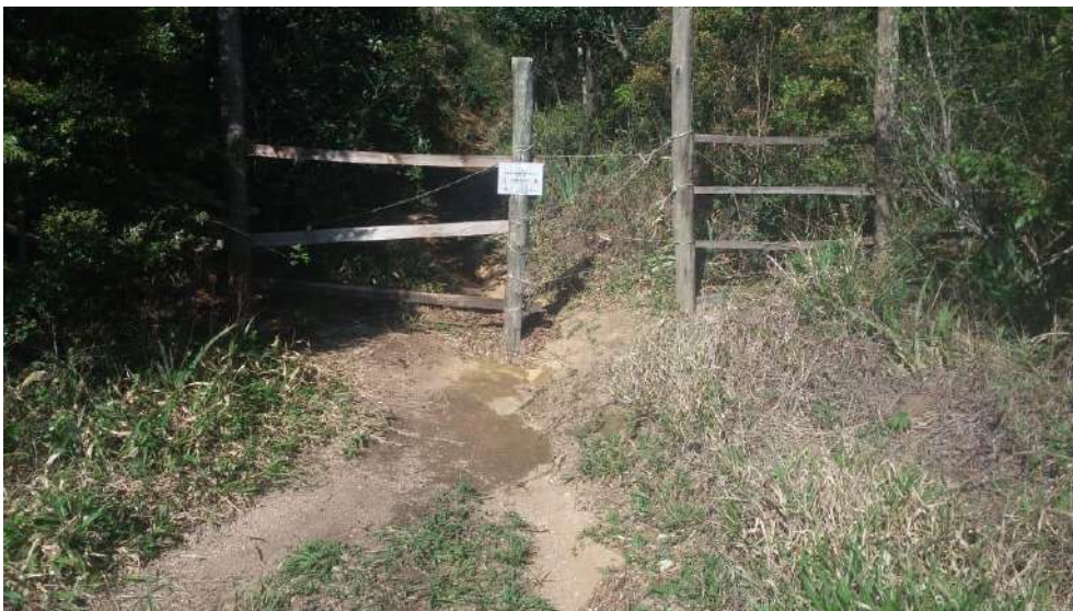
Figura 3 - Manutenção de fechamento utilizando sisal, com destaque para a presença da placa de advertência
