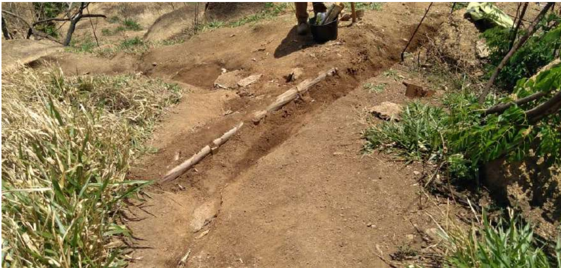
Figura 41 - Saída de água modificada após análise das primeiras chuvas
