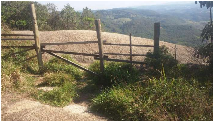
Figura 8 - Barreira laje Sul quebrada novamente em um período de final de semana
