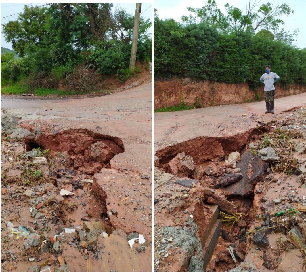
Fotos 28 e 29 Afundamento de solo Av. Santana
