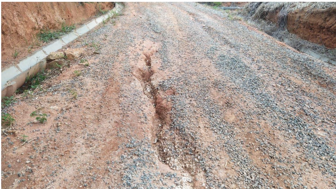
Fotos 25, 26 e 27 Processo erosivo estrada CAV-GF
