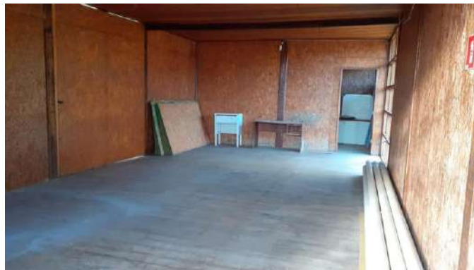
Foto 1 Área da sede no salão térreo após limpeza
