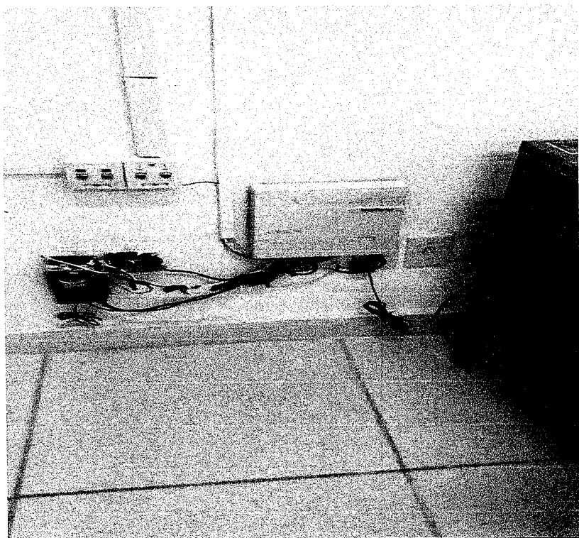
Instalação e configuração de central PABX
