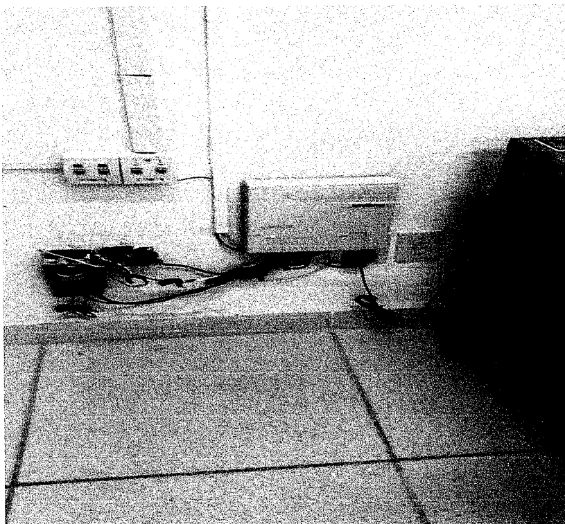
Instalação e configuração de central PABX
