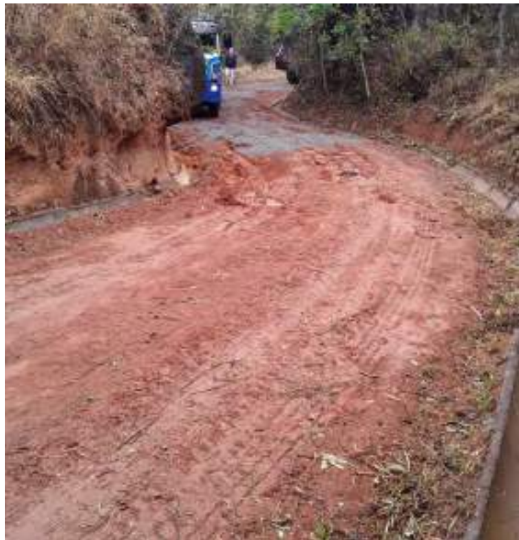
Figura 35 – Estado de conservação da estrada de acesso ao CAVGF no último dia da manutenção.
