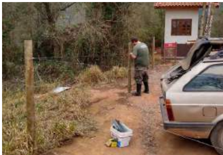
Figura 81 – Finalização da reinstalação e tencionamento dos arames no cercamento do Mirante Natural da Pedrinha, realizado em setembro de 2022.
