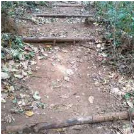
Figura 52 – Degraus de madeira em decomposição e as em bom estado de conservação, levantado em agosto de 2022.
