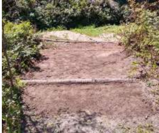
Figura 67 – Escadas hidráulicas após o manejo, realizado em junho de 2022.
