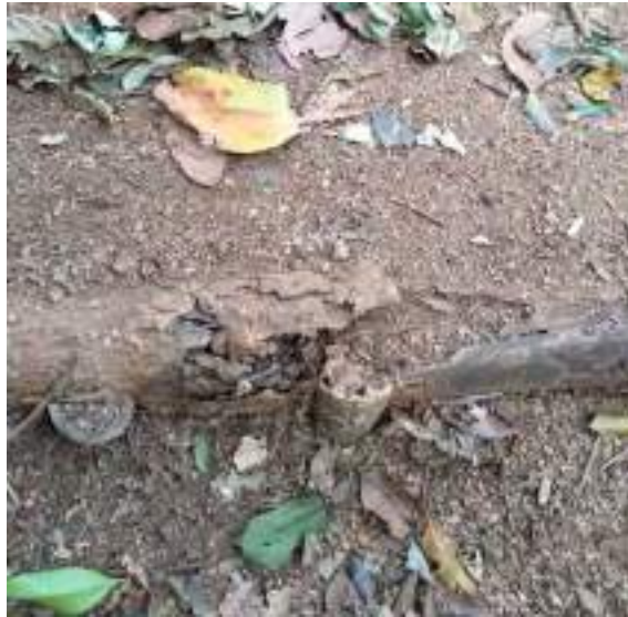
Figura 51 – Degrau de madeira em decomposição, levantado em agosto de 2022.
