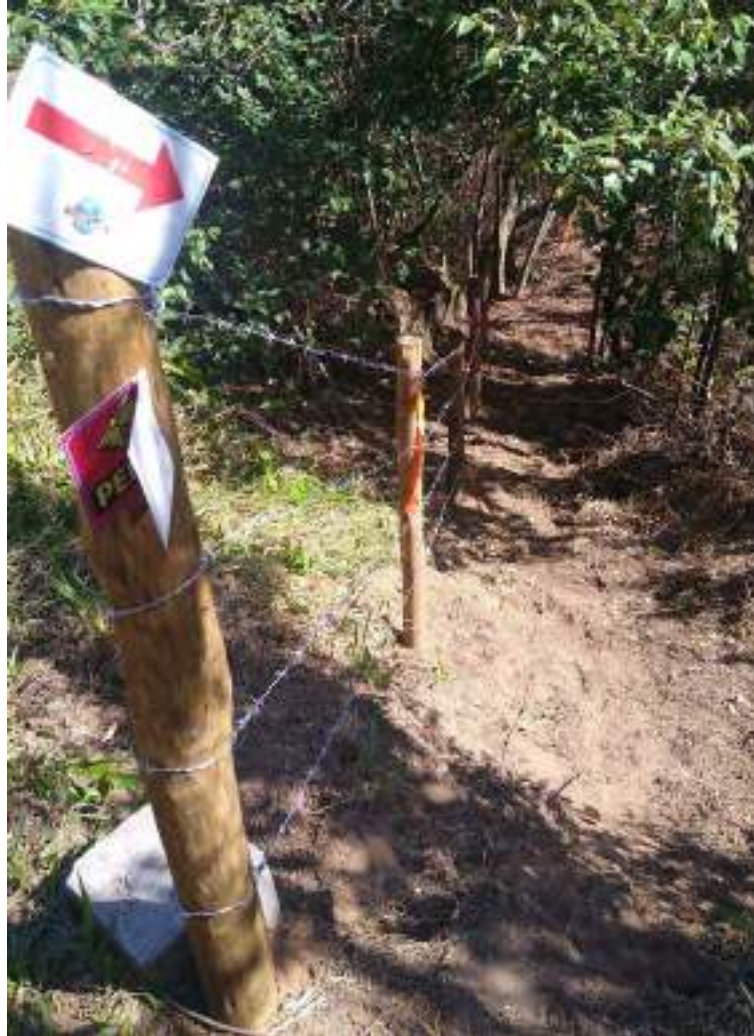
Figura 41 – Pontos da cerca concertados na região da Laje do CAVGF, realizado em agosto de 2022.
