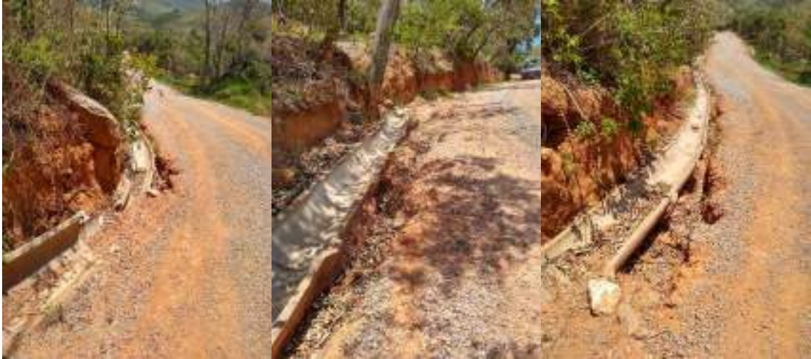
Figura 36 – Processos erosivos acarretados pela falta de compactação da estrada de acesso ao CAVGF.
