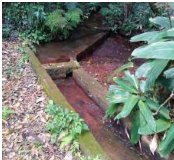
Figura 63 – Margens da Antiga Barragem de Captação de Água após as manutenções, realizado em setembro de 2022.
