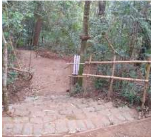
Figura 49 – Instalação do banco de madeira na entrada que leva ao Castelinho, realizado em agosto de 2022.
