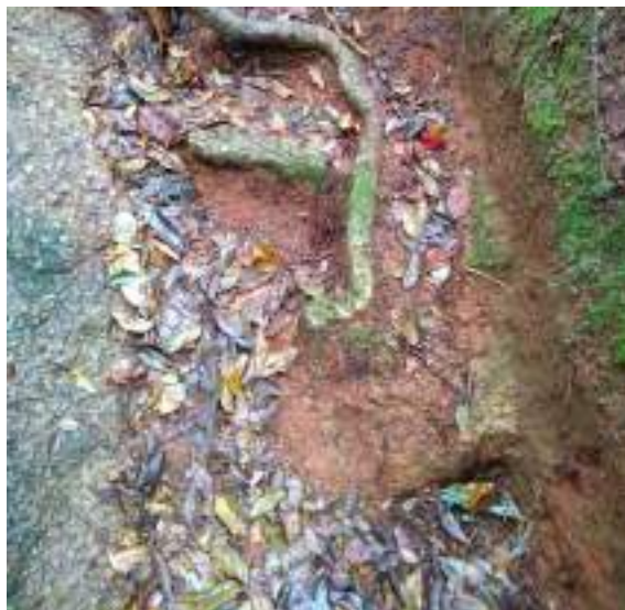
Figura 55 – Local sem escadas hidráulicas sofrendo processos erosivos, levantado em agosto de 2022.
