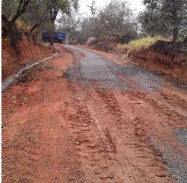
Figura 85 – Trecho da estrada de acesso ao CAVGF com ponto de pedrisco sem compactação, realizado em setembro de 2022.
