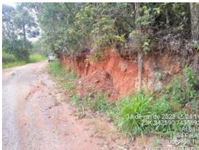
Figura 34 – Ponto RI_003 que apresenta desabamento de solo na estrada do CAVGF.
