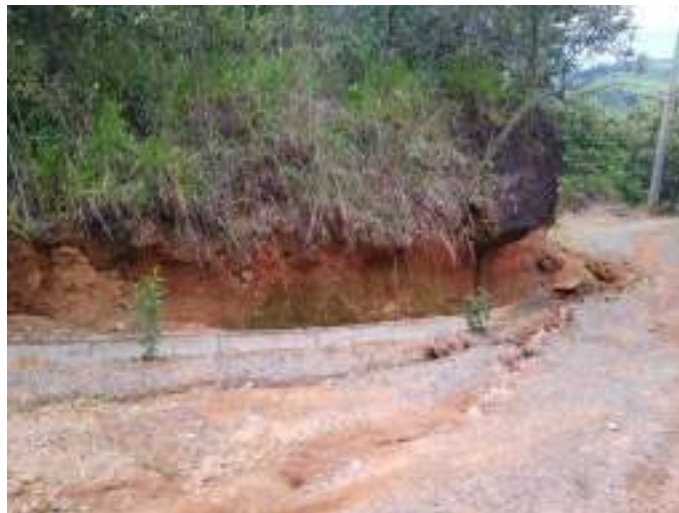
Figura 36 – Erosão próxima ao ponto RI_005 que apresenta desabamento de solo e rocha na estrada do CAVGF.
