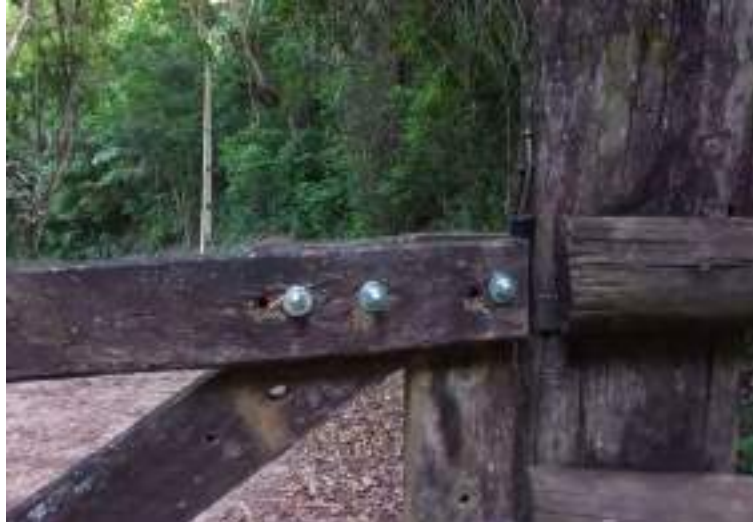
Figura 82 – Três novos furos realizados para a instalação da dobradiça na porteira de acesso à Capela de Santo Antônio, janeiro de 2023.
