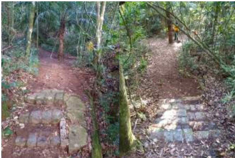
Figura 51 – Manutenção das escadas em trecho da Trilha do Saci, realizada em novembro de 2022.
