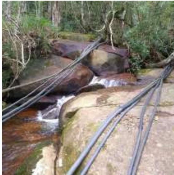
Figura 47 – Canos fazem a captação irregular de água a jusante da barragem, realizada em janeiro de 2023.
