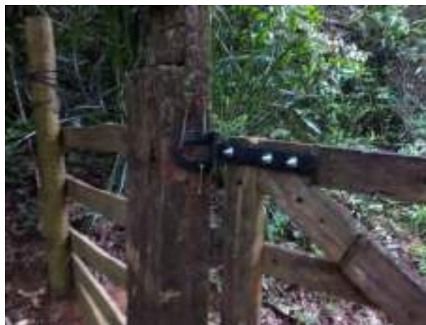
Figura 81 – Dobradiça da porteira de acesso à Capela de Santo Antônio trocada, janeiro de 2023.
