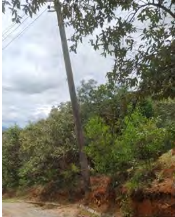
Figura 35 – Poste com risco de queda na estrada de acesso ao CAVGF.
