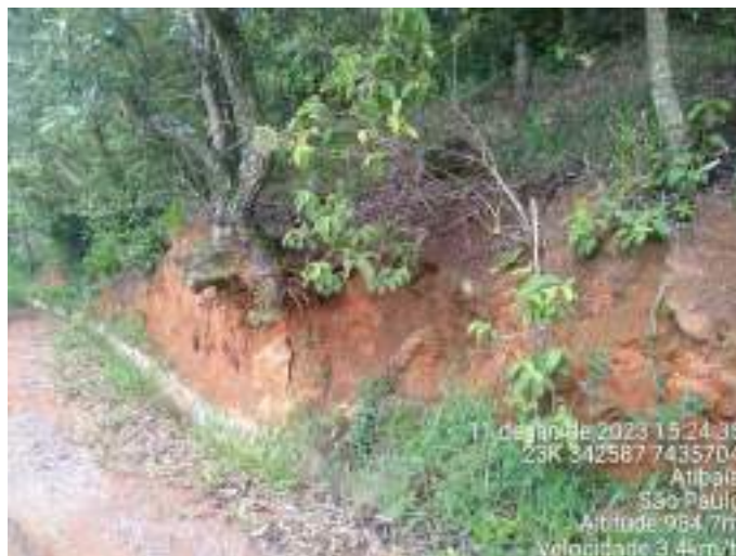
Figura 33 – Ponto RI_004 que apresenta desabamento de solo e risco de queda de árvore na estrada do CAVGF.
