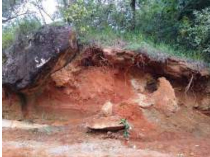
Figura 32 – Ponto RI_005 que apresenta desabamento de solo e rocha na estrada do CAVGF.
