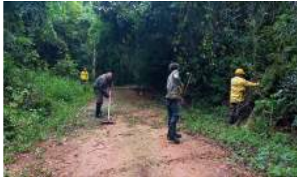
Figura 79 – Manutenção e limpeza da área de queda de árvore na estrada de acesso à Capela, dezembro de 2022.
