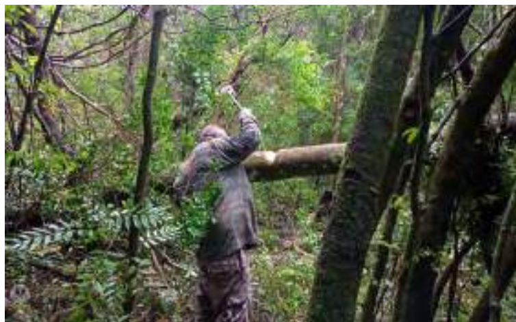
Figura 78 – Manutenção e corte de árvore caída na estrada de acesso à Capela, dezembro de 2022.
