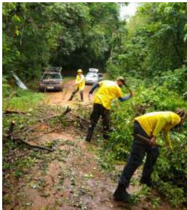
Figura 44 – Remoção de árvore caída na estrada de acesso à Capela de Santo Antônio, realizada em dezembro de 2022.
