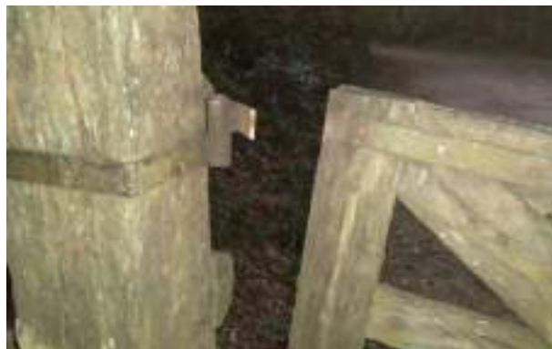
Figura 80 – Avaria e trincho na dobradiça da porteira de acesso à Capela de Santo Antônio, janeiro de 2023.
