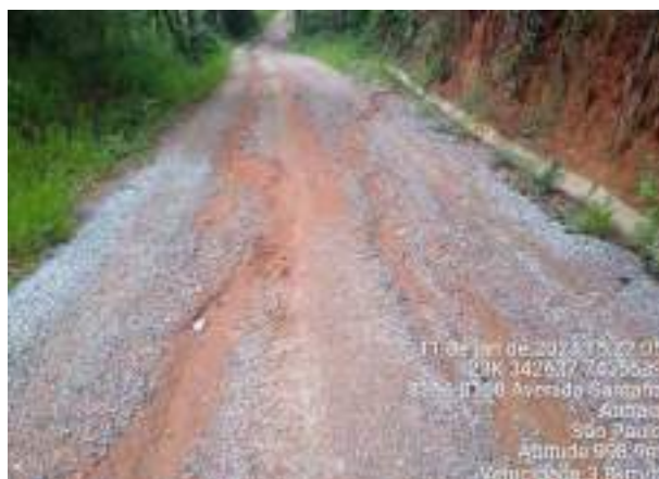
Figura 21 – Ponto EA_011 depois de passar pela antiga barragem de captação de água é possível verificar a formação de processos erosivos, decorrente das obras de drenagem pluvial ineficientes em toda a extensão da estrada de acesso.
