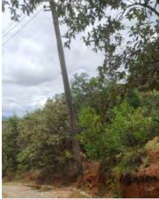
Figura 7 – Ponto RI_006 com risco de queda do poste de iluminação pública.
