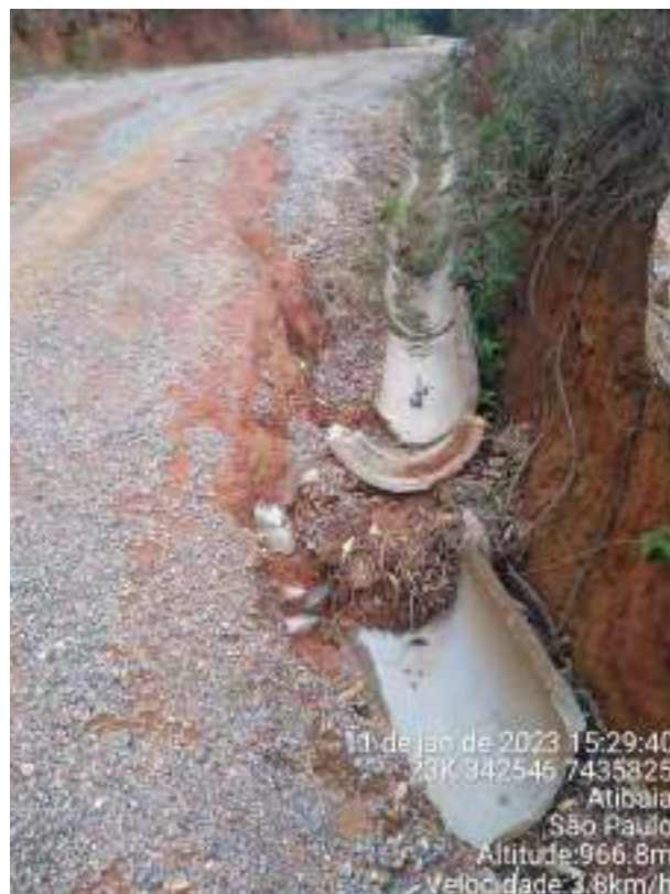
Figura 23 – Ponto EA_013 onde já houveram ocorrências de mais de um veículo que derrapou e acabou por cair dentro da calha de drenagem, danificando-a.
