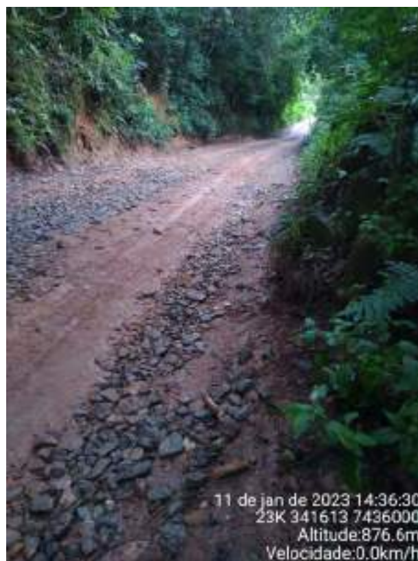
Figura 13 – Ponto EA_003 após passar a entrada do Loteamento Vale das Pedras, um outro trecho com processos erosivos recorrentes, do mesmo modo, foi realizada a manutenção do trecho com cascalho sem a devida compactação, causando derrapamento durante a subida e novas valetas, entretanto com as chuvas o cascalho tem sido levado pelo escoamento superficial para as cotas mais baixas.
