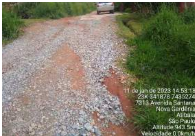
Figura 17 – Ponto EA_009 que apresentava processo erosivo avançado e foi realizada a manutenção sem a compactação adequada, apresentando cascalhos solto e que com as fortes chuvas pode ser carregado à jusante, aumentando novamente a erosão do local.
