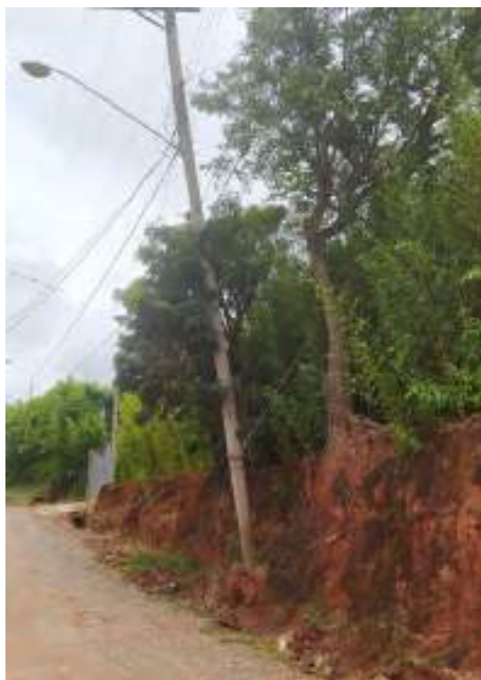
Figura 6 – Ponto RI_002 com risco de queda do poste de iluminação pública.
