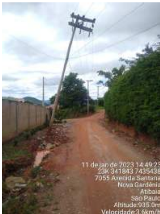
Figura 5 – Ponto RI_001 com risco de queda do poste de iluminação pública.
