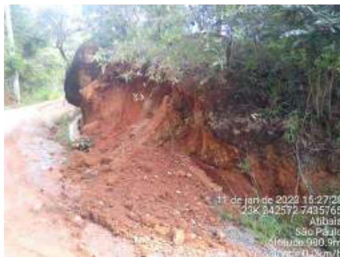
Figura 4 – Ponto RI_005 com risco de desbarrancamento do talude e rolamento de rocha na estrada de acesso ao CAVGF.
