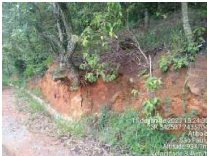
Figura 3 – Ponto RI_004 com risco de desbarrancamento do talude e queda de árvore na estrada de acesso ao CAVGF.
