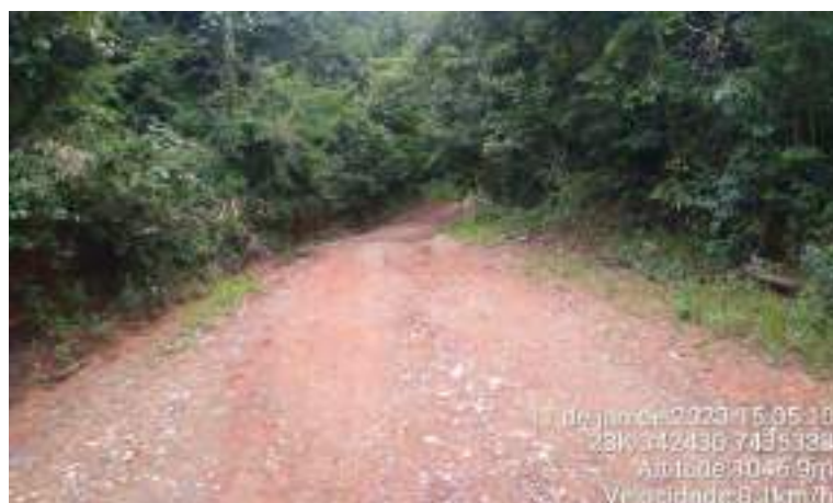
Figura 18 – Ponto EA_010 após a porteira de entrada do PNMGF há um trecho da estrada com rochas e buracos que fazem os veículos rasparem em baixo, também sem a possibilidade de desviar devido à processos erosivos na margem de menor cota da estrada.
