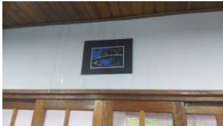
Figura 26 – Ponto de infiltração na Sede Ambiental decorrente da má instalação das placas e instabilização estrutural, ocorrido em 11 de novembro de 2022.
