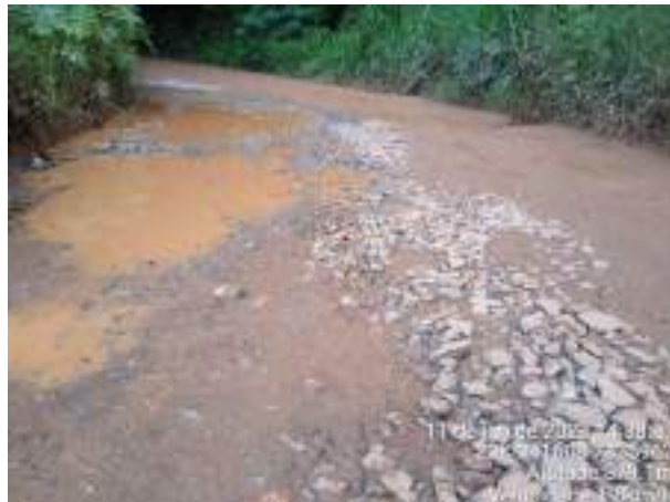
Figura 14 – Ponto EA_004 de assoreamento dos cascalhos utilizados para a manutenção à montante da estrada, onde não foi feita a manutenção e além de sedimentos a água também fica empessada no local.
