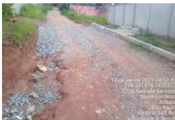
Figura 16 – Ponto EA_008 que apresentava processo erosivo avançado e foi realizada a manutenção sem a compactação adequada, apresentando cascalhos solto e que com as fortes chuvas pode ser carregado à jusante, aumentando novamente a erosão do local.
