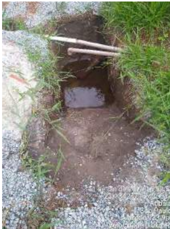
Figura 29 – Ponto com buraco decorrente do serviço incompleto de ajuste do abastecimento de água, ao lado da Casa do Fogo.
