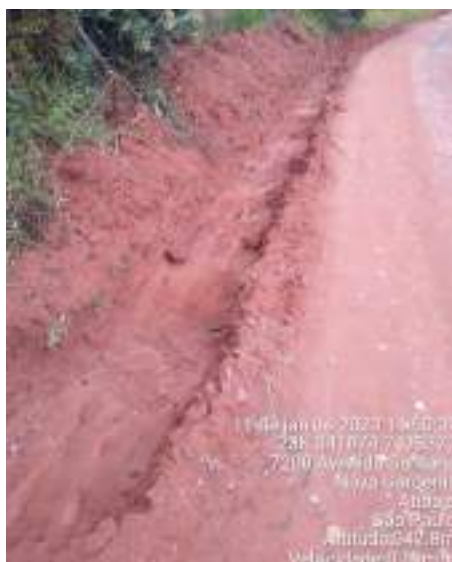
Figura 20 – Ponto EA_007 poucos metros à frente de onde foi feita uma canaleta de drenagem com trator, que auxiliou o escoamento em alguns pontos, mas pode se tratar de um risco à queda de veículos devido ao estreitamento da via.
