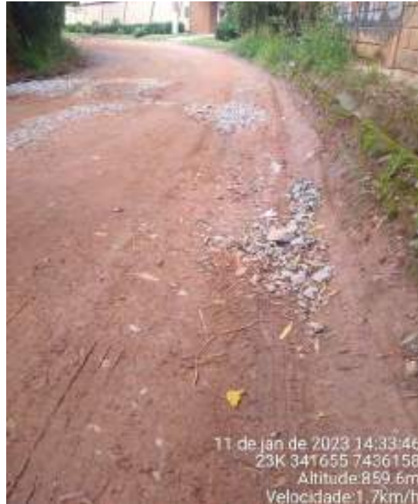
Figura 12 – Ponto EA_002 poucos metros acima da curva do Tiguera, uma outra erosão decorrente do escoamento superficial e dos equipamentos de drenagem superficial ineficientes, foi realizada a manutenção com cascalho que sem a devida compactação e com as chuvas torrenciais o processo persiste.
