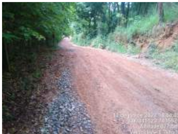
Figura 15 – Ponto EA_005 antes do início do penúltimo trecho de asfalto da Av. Santana, que recebe uma grande carga de escoamento superficial, foi realizada a manutenção recentemente com cascalho e terra, entretanto não foi realizada a compactação adequada o que forma lama junto ao cascalho e favorece o derrapamento. Do mesmo modo, nesse trecho devido as erosões laterais da via apenas são possíveis passar um veículo por vez.
