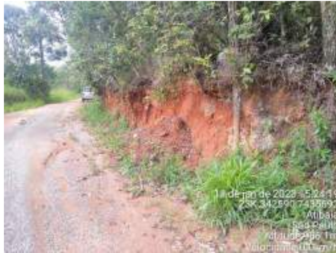
Figura 2 – Ponto RI_003 com risco de desbarrancamento do talude da estrada de acesso ao CAVGF.
