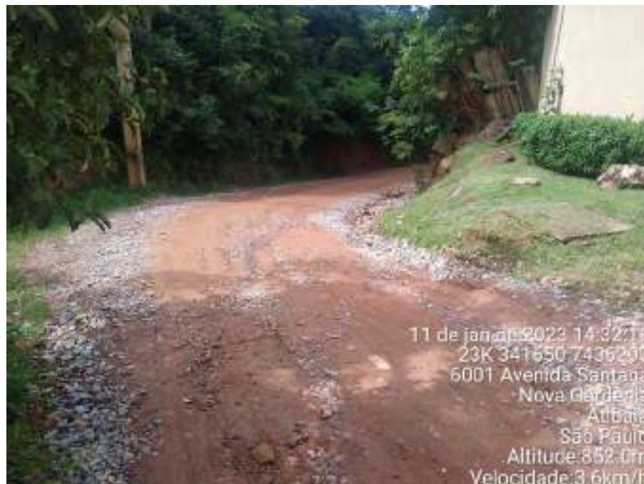
Figura 11 – Ponto EA_001 denominado curva do Tiguerá, onde corriqueiramente ocorrem processos erosivos avançados, foi realizada a manutenção com cascalho e sem a devida compactação e com as chuvas torrenciais algumas valas grandes persistem.
