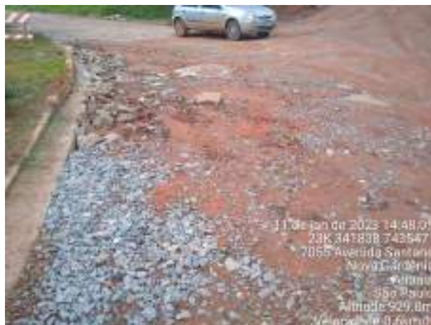
Figura 19 – Ponto EA_006 no término do penúltimo trecho de asfalto, onde foi realizada uma obra de drenagem pluvial, entretanto, esta é ineficiente pois não suporta a vazão de escoamento superficial gerado pelas vias, além do fato de carrear sedimentos para as cotas mais baixas e dificultar a entrada e saída no morador local.
