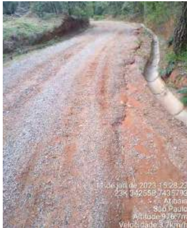
Figura 22 – Ponto EA_012 na penúltima curva, já chegando ao CAVGF, novamente são visíveis os processos erosivos na estrada de acesso devido a drenagem pluvial ineficiente. Além do fato de na última manutenção não ter sido realizada de forma correta a compactação da estrada, deixando pedriscos soltos que trazem risco aos veículos de derraparem durante a descida e a subida.
