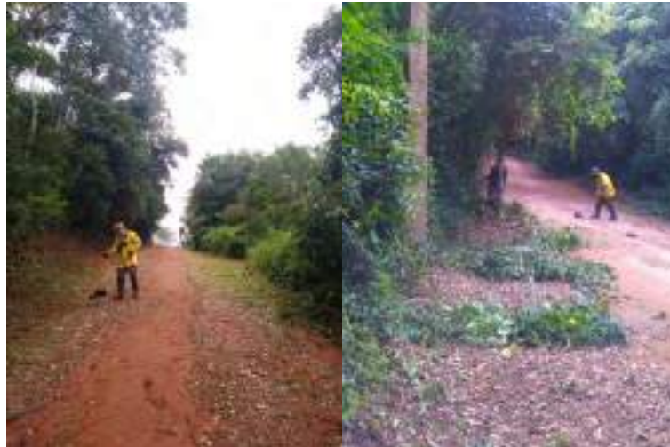
Figura 7 –Roçagem e poda nas estradas de acesso internas ao Parque, realizado em fevereiro de 2023.
