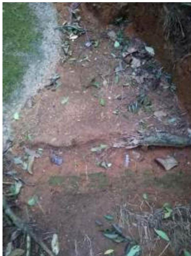
Figura 66 – Degrau decomposto antes da manutenção.
