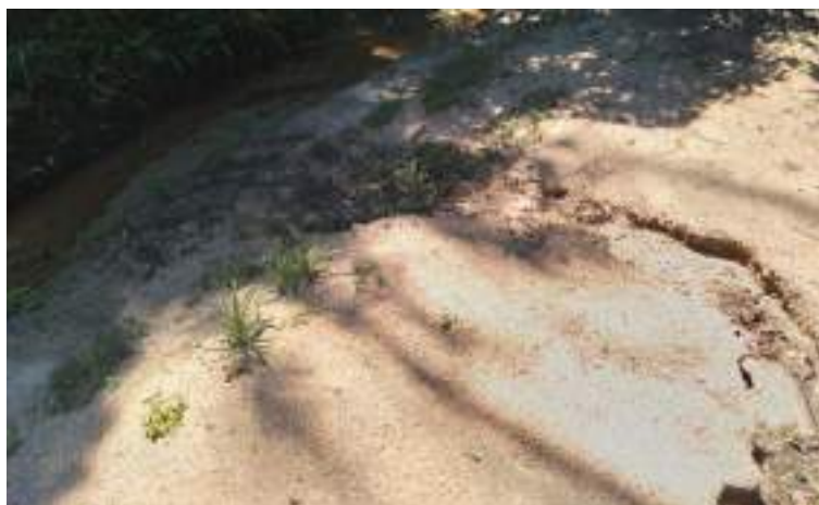
Figura 71 – Setor I do Córrego do Milho Vermelho com processos erosivos após as ações de manutenção.
