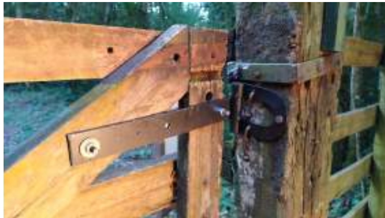
Figura 81 – Dobradiça que foi necessária substituir na porteira de acesso à Capela de Santo Antônio em maio de 2022.
