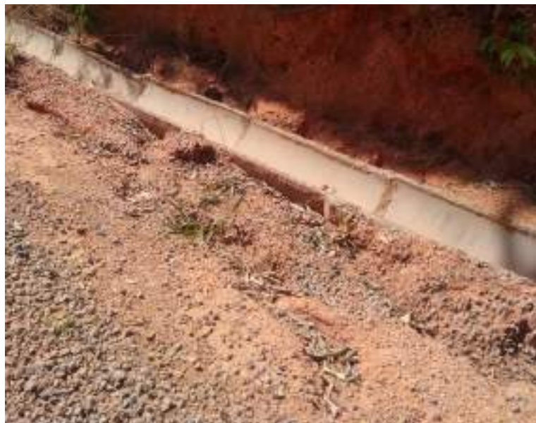
Figura 40 – Erosão na estrada de acesso resultante da manutenção.
