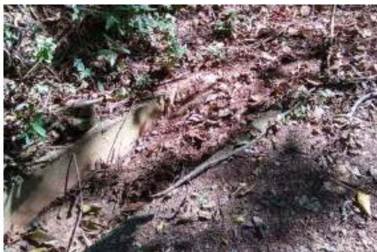
Figura 41 – Sedimentação e obstrução dos canais de drenagem resultantes da manutenção na estrada de acesso.
