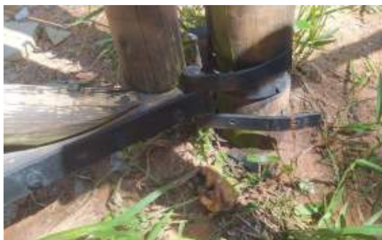
Figura 83 – Dobradiça que precisou ser reforçada na porteira de acesso ao PNMGF em maio de 2022.
